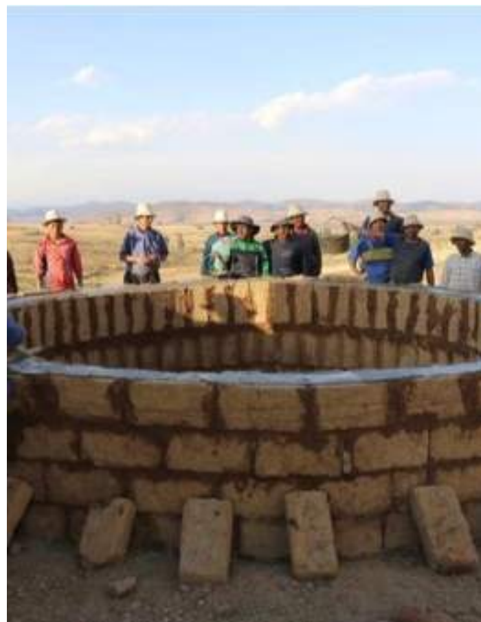
Ilustración BC10: Sistema de almacenamiento de agua | Ivan del Callejo Veracc
