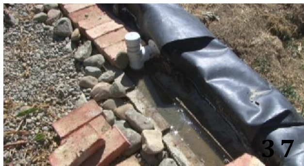
37. Sistema de aplicación de agua residual en funcionamiento.
