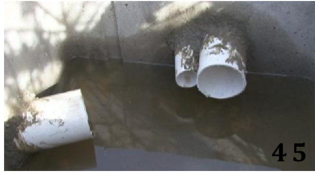
45. Cámara de mezcla de aguas grises y negras.
