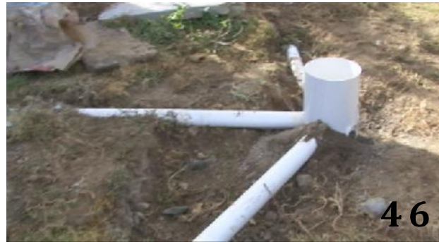
46. Cámara de recolección de aguas grises.
