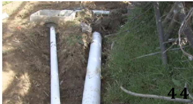
44. Tubería de aguas grises (izq.) y de aguas negras (der.) antes de su ingreso a la cama de mezclado.
