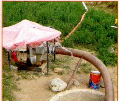
Figura 5. Cámaras de limpieza utilizadas como punto de bombeo
