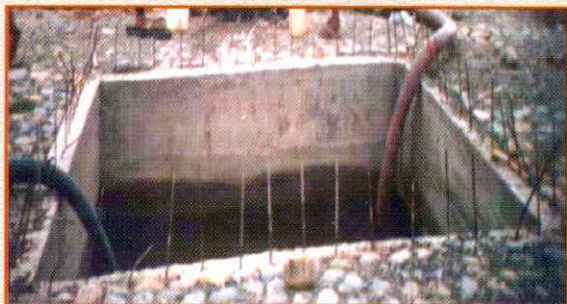
Figura 6. Cárcamo de bombeo
