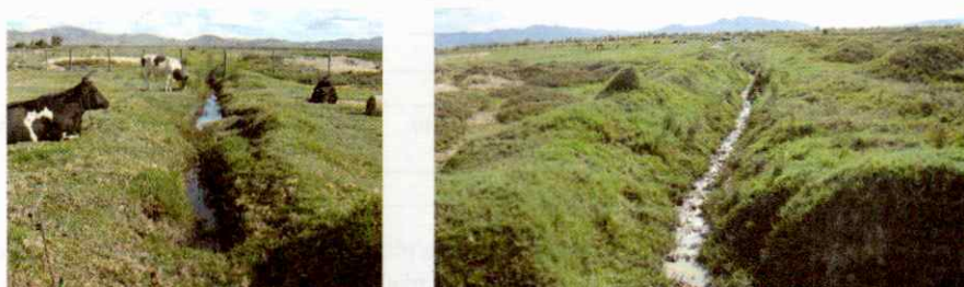
Figura 5: Infraestructura de conducción de aguas residuales: planta tratamiento –cámaras
