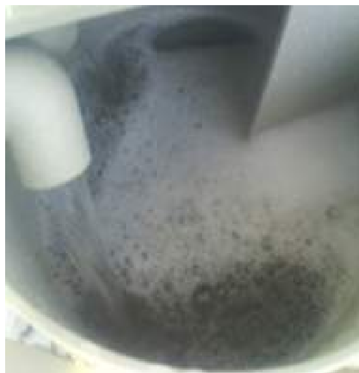
Ilustración BC4: Agua en tratamiento
