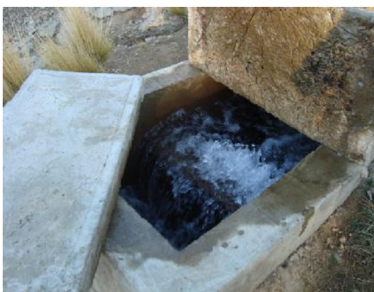
Fig. 12 Cámara rompe presión.
