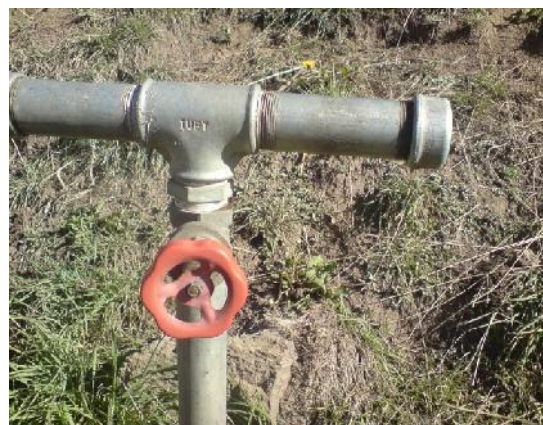
Fig. 13 Hidrante de dos salidas.
