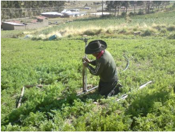
Fig. 30 Porta aspersor instalado con estaca.
